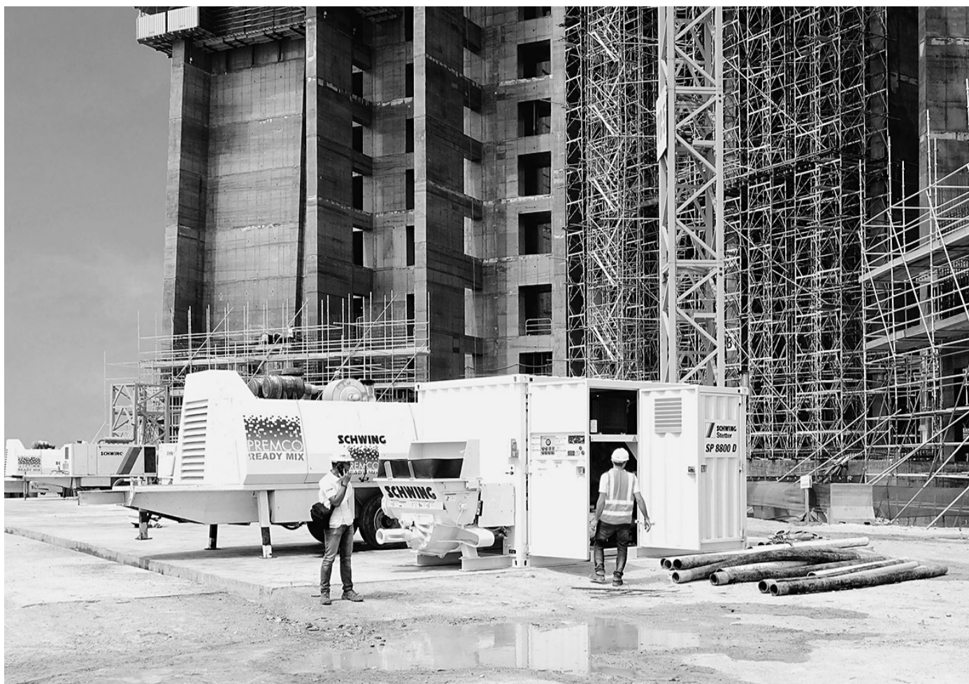
Noch ohne Förderrohre: Die vier Stationärpumpen SP 8800 D (davon eine als Container-Version) werden nach ihrer Ankunft auf der Baustelle installiert und für den Pumpeinsatz vorbereitet. Foto: Schwing-Stetter
